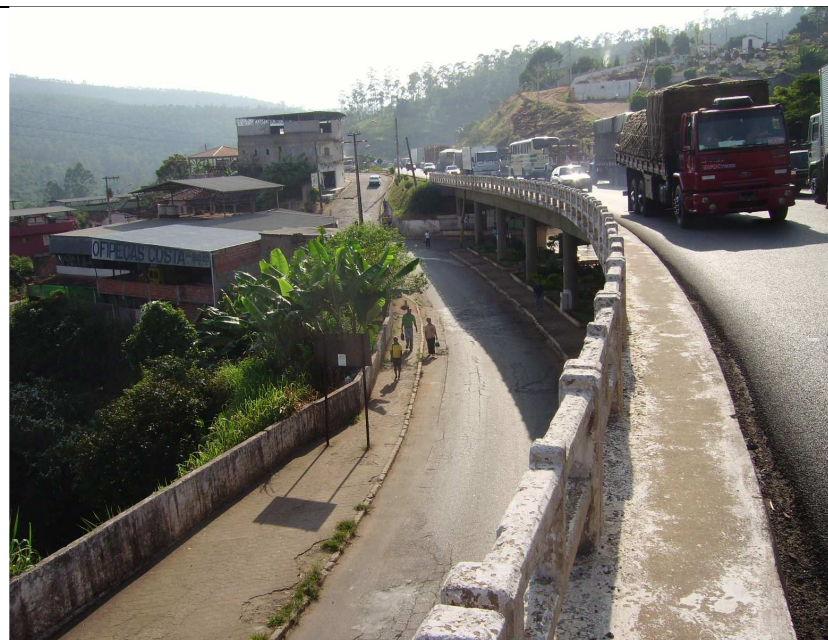
Figura 7 – Vista da passagem da rodovia sobre a área urbana de Bela Vista de Minas. Observe-se a fragilidade do guarda-corpo e sua pequena distância à pista..
