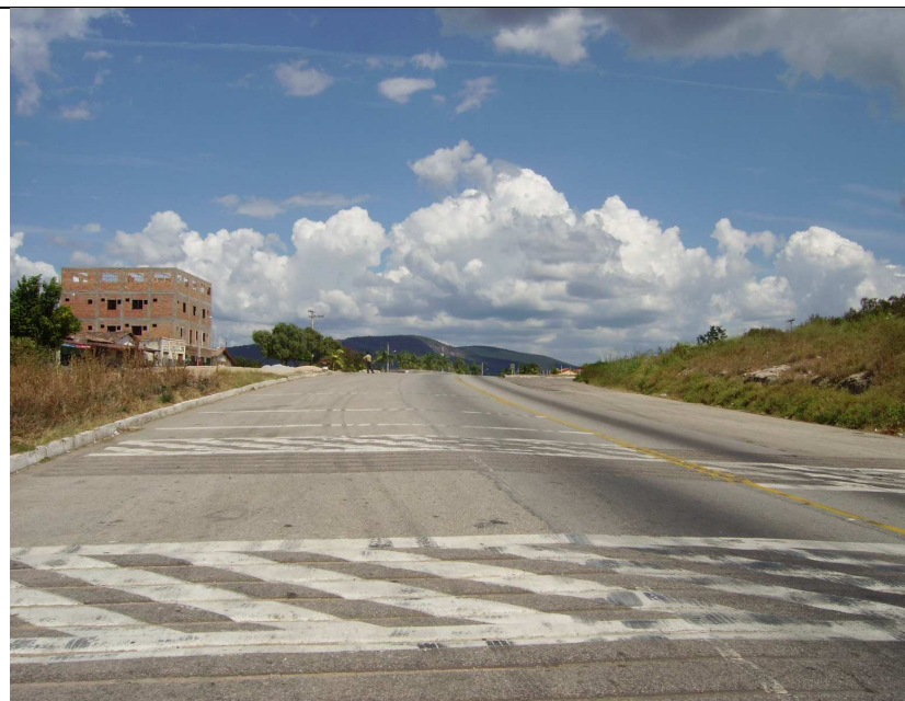
Figura 53 - O segundo trecho apresenta deficiências na separação entre os tráfegos locais e rodoviários.
