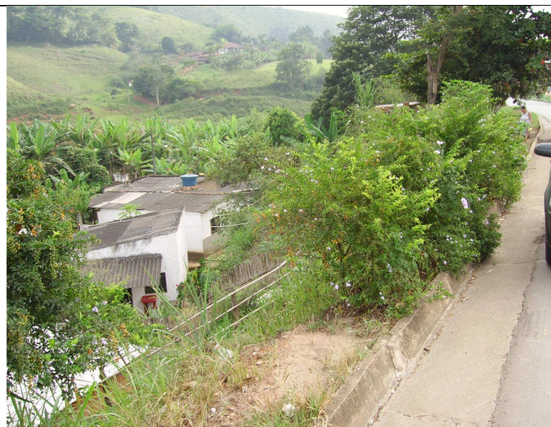
Figura 8 - Além da invasão da faixa de domínio há o risco de tombamento de veículos sobre as edificações por falta de guarda corpo.
