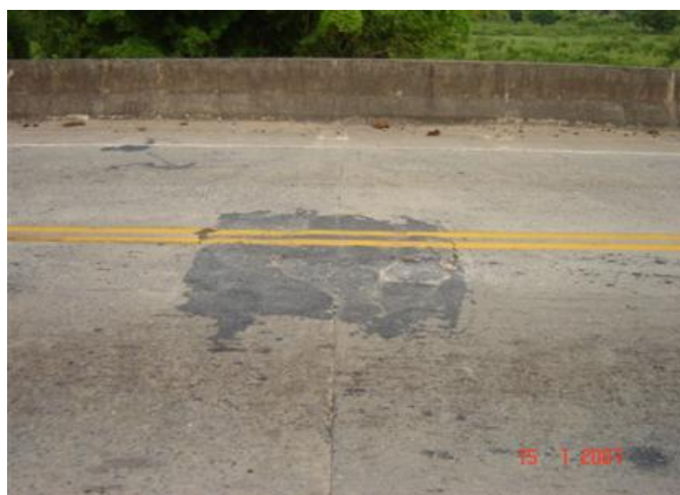
FOTO 4: Pavimento Rígido Deteriorado
