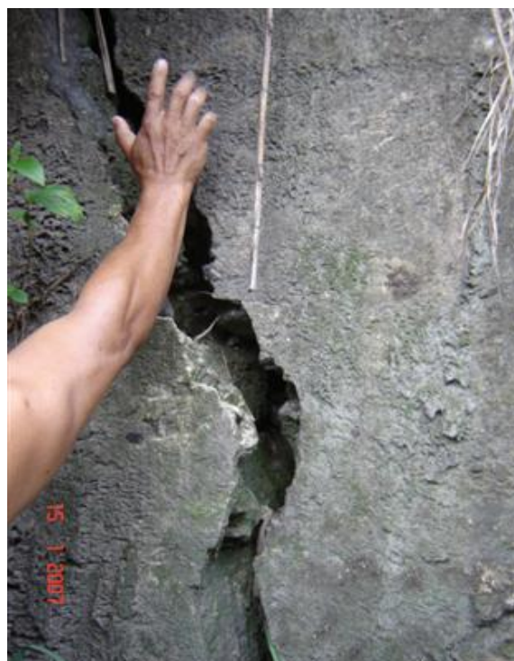
FOTO 4: Trinca na Ala (rompimento)
