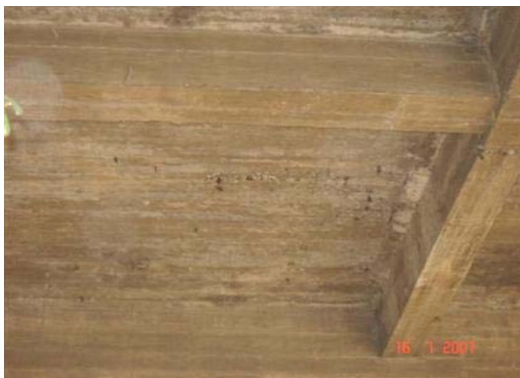
FOTO 4: Concreto Segregado na Laje
