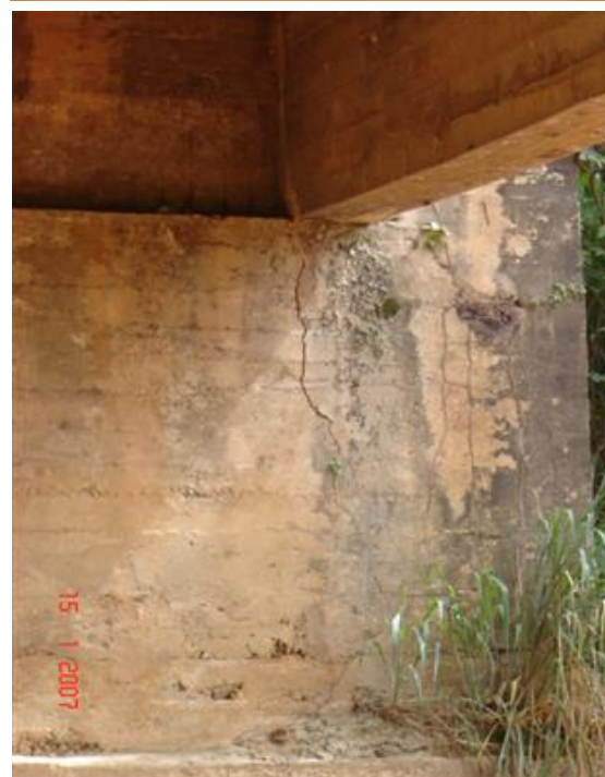
FOTO 5: Trinca no Encontro Norte
