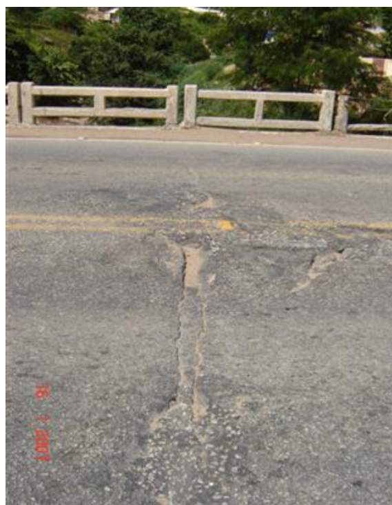
FOTO 4: Pavimento, Juntas Danifidadas
