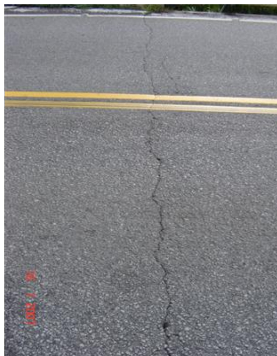
FOTO 4: Trinca no Pavimento Encontro
