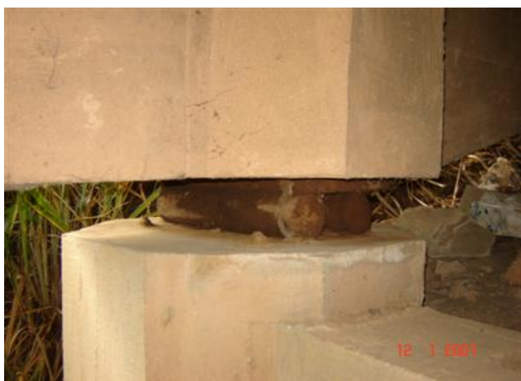
FOTO 4: Apoio em Rolete Metálico
