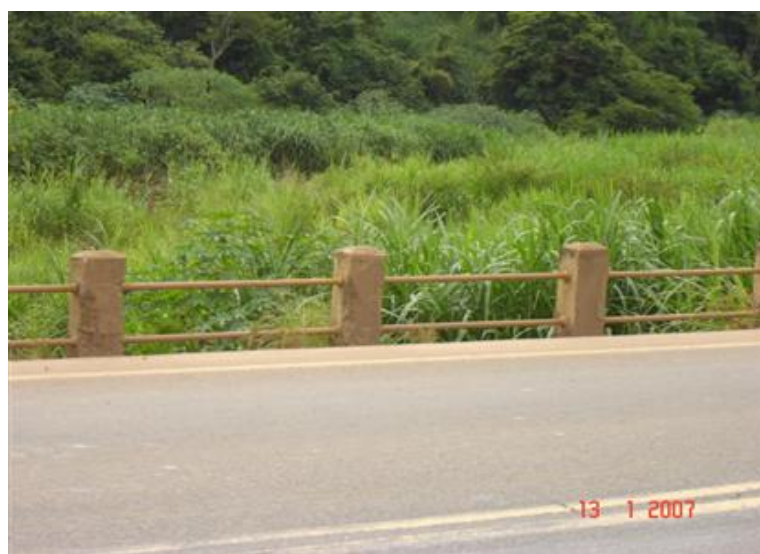
FOTO 4: Guarda-Corpo fora de padrão
