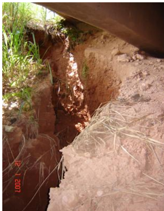
FOTO 4: Erosão no encontro Norte
