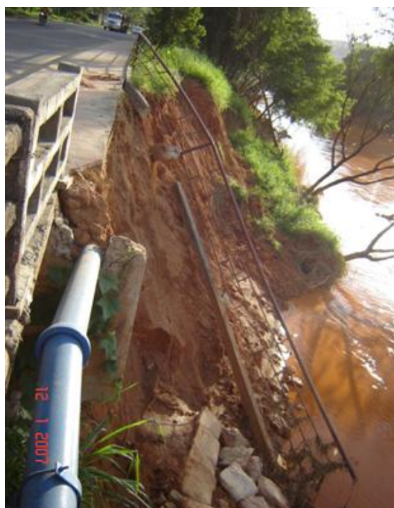
FOTO 4: Erosão na cabeceira Norte
