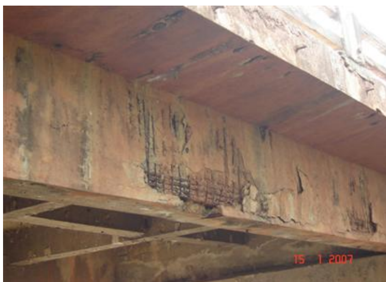
FOTO 4: C.D. + A.E.O. com Perda de Seção na Longarina
