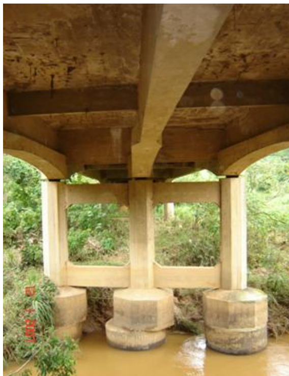
FOTO 3: Vista Inferior da Obra Excentricidade Apoio da Infra
