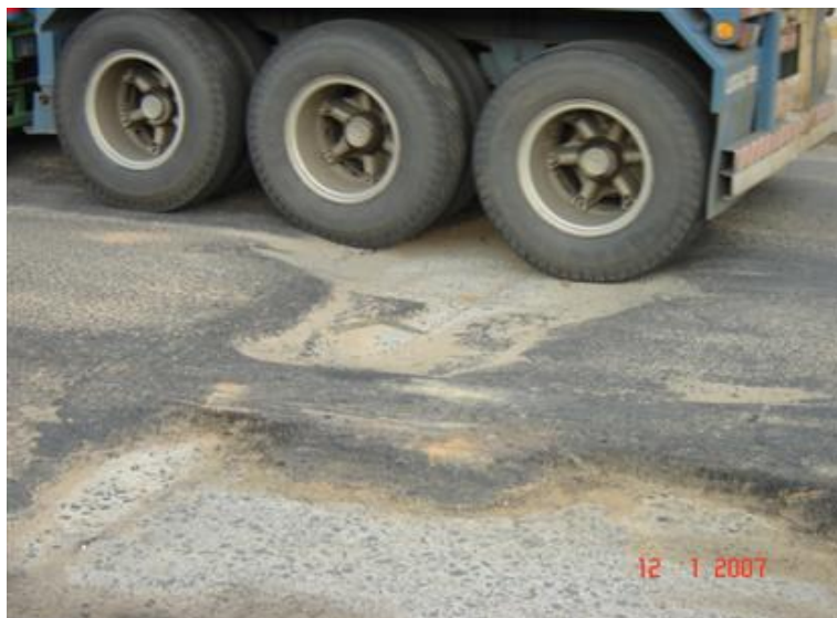
FOTO 3: Junta de dilatação deteriorada
