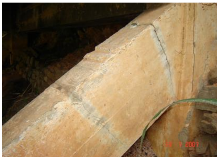
FOTO 4: Trinca em uma Viga Diagonal
