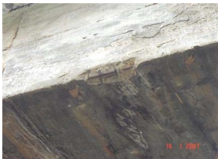
FOTO 4: Marca de Impacto no Caixaão
