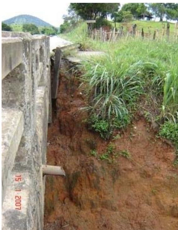
FOTO 4: Erosão na Cabeceira da Pista
