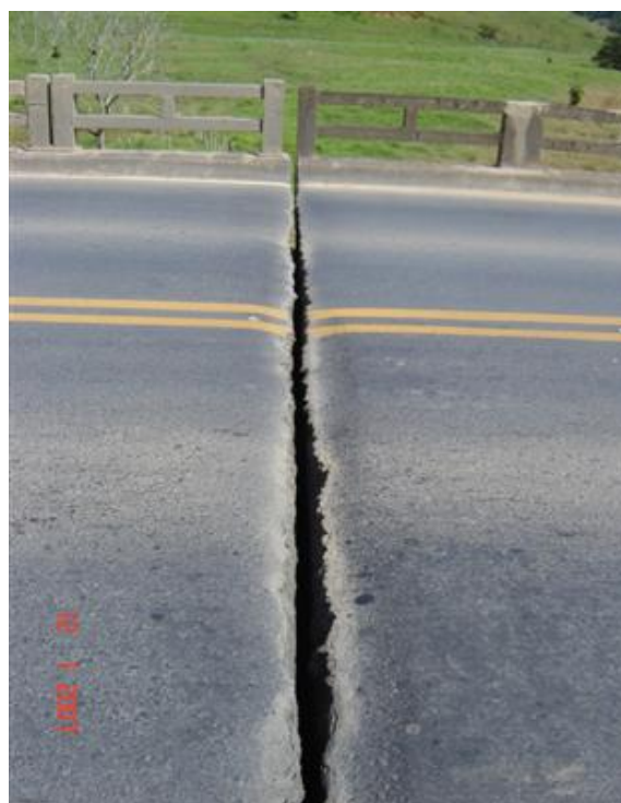
FOTO 4: Junta excessivamente aberta
