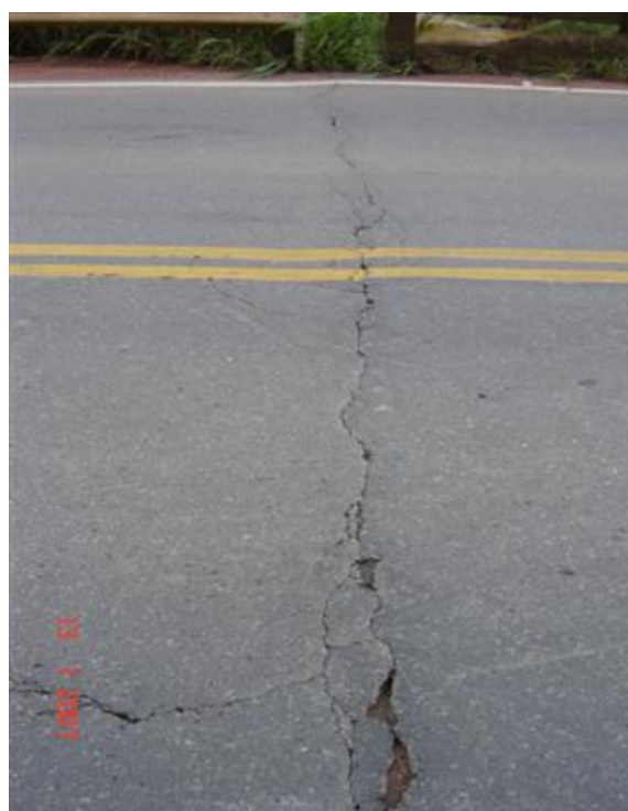
FOTO 4: Trinca na Posição da Junta
