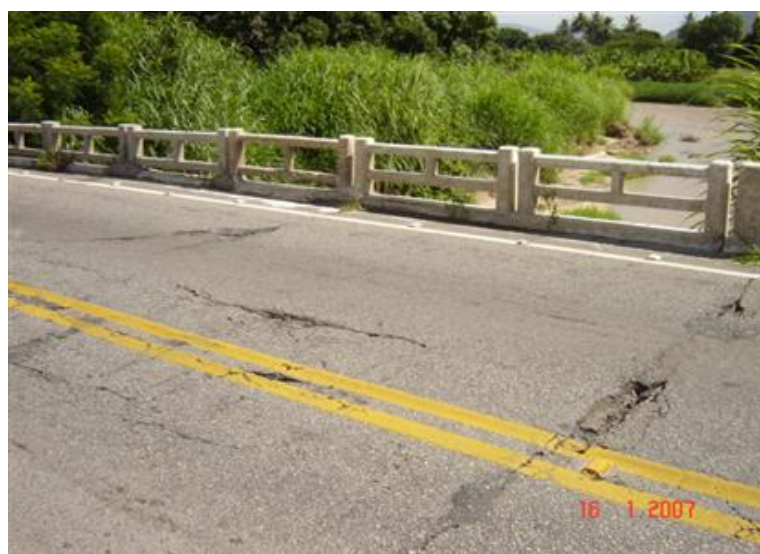
FOTO 4: Pavimento, Juntas Danifidas
