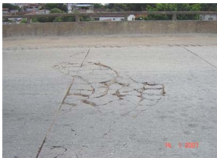
FOTO 4: Pavimento Rígido Deteriorado
