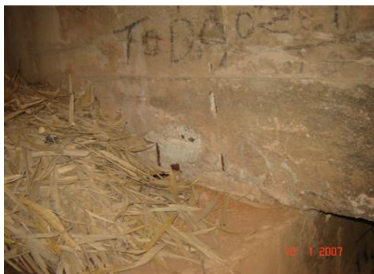
FOTO 4: Esmagamento do Apoio
