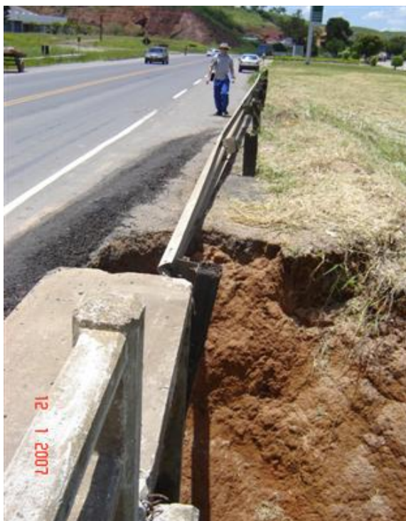
FOTOS 4 e 5 Erosão na cabeceira do encontro Norte
