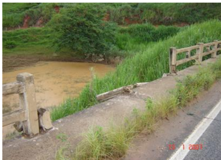
FOTO 4: Guarda - Corpo Faltante
