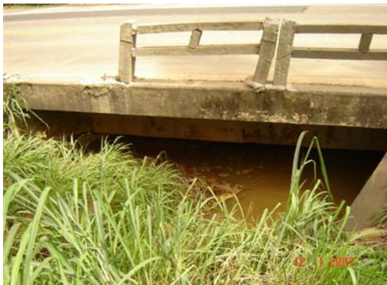
FOTO 3: Guarda - Corpo Faltante
