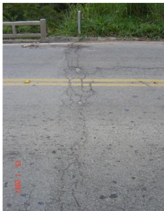
FOTO 4: Trinca Pavimento Encontro
