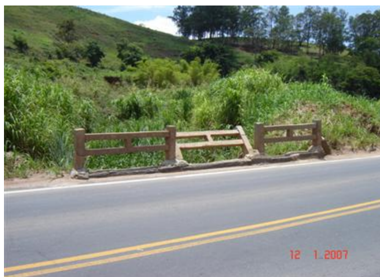
FOTO 4: Guarda - Corpo Deteriorado
